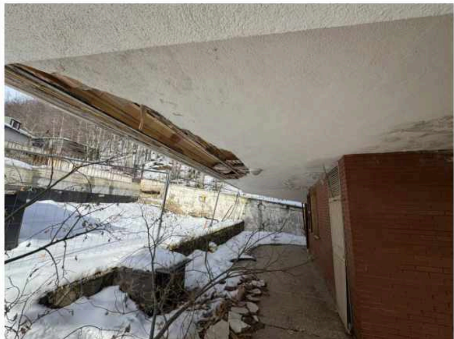
- villino - spazio esterno (piano terra) - ammaloramenti e distacchi diffusi su tutte le superfici
