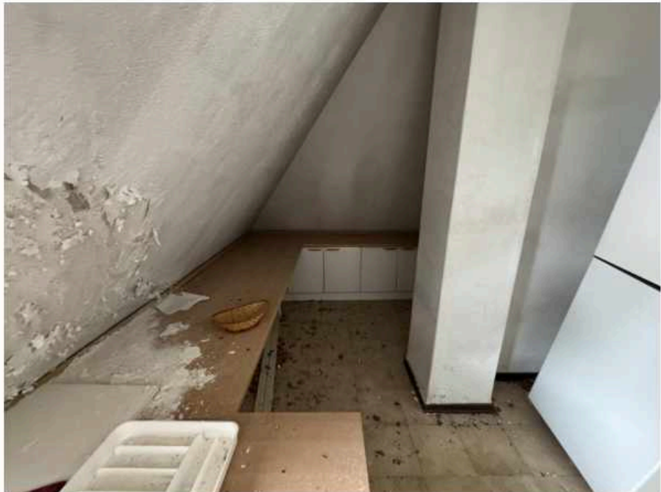
- villino (piano primo) – cucina - ammaloramenti e distacchi diffusi su tutte le superfici murarie
