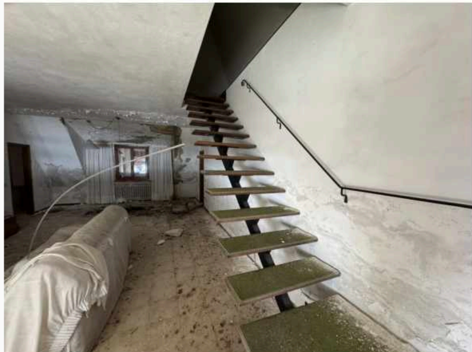
- villino (piano primo) – scala - ammaloramenti e distacchi diffusi su tutte le superfici murarie
