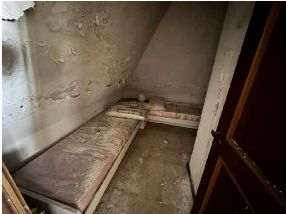
- villino (piano primo) – camera 1 - ammaloramenti e distacchi diffusi su tutte le superfici murarie
