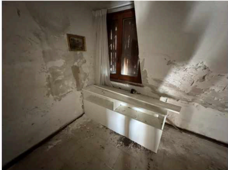
- villino (piano primo) – camera 2 - ammaloramenti e distacchi diffusi su tutte le superfici murarie
