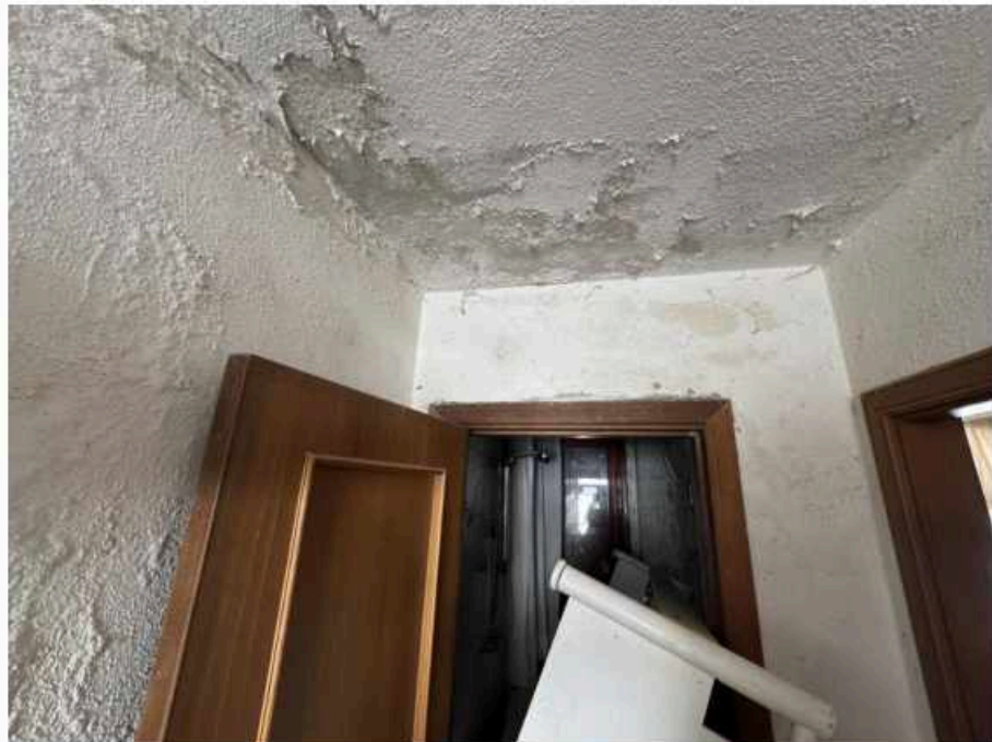
- villino (piano terra) – ammaloramenti e distacchi diffusi su tutte le superfici murarie
