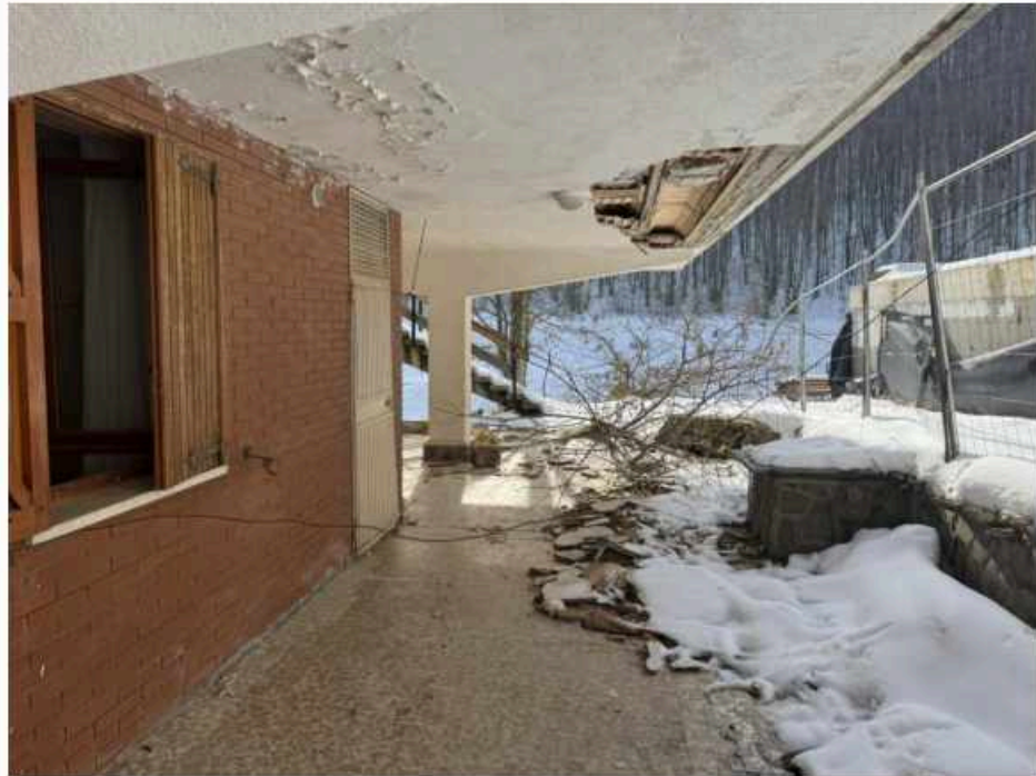
- villino (piano terra) – finestra e porta d'ingresso locale caldaia - ammaloramenti e distacchi diffusi
