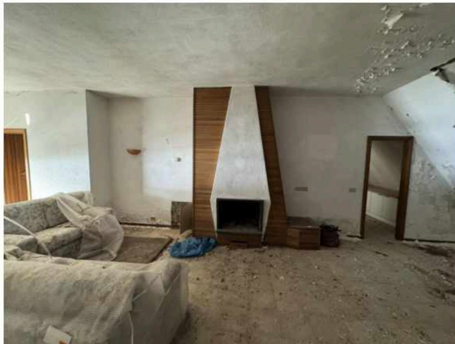
- villino (piano primo) – soggiorno/pranzo - ammaloramenti e distacchi diffusi su tutte le superfici murarie
