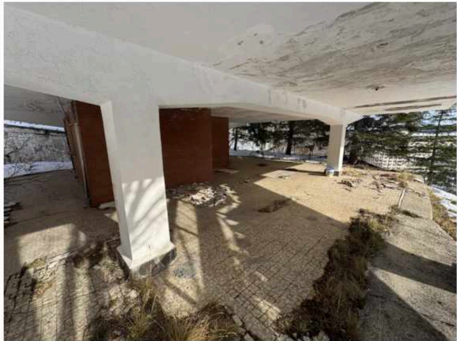
- villino - spazio esterno (piano terra) - pavimentazione dissestata e ammaloramenti diffusi
