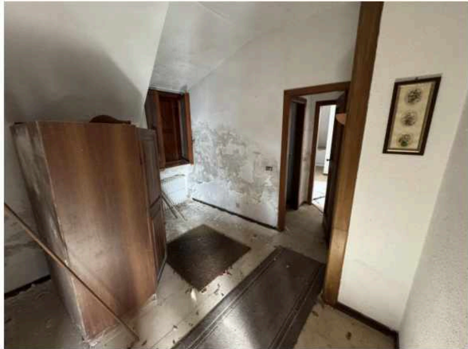
- villino (piano primo) – zona d'ingresso - ammaloramenti e distacchi diffusi su tutte le superfici murarie
